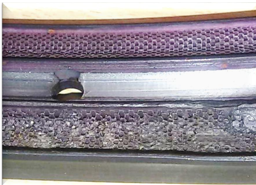
Рисунок 1.10 – Внешний вид сотового покрытия тромбированного продуктами коррозии
